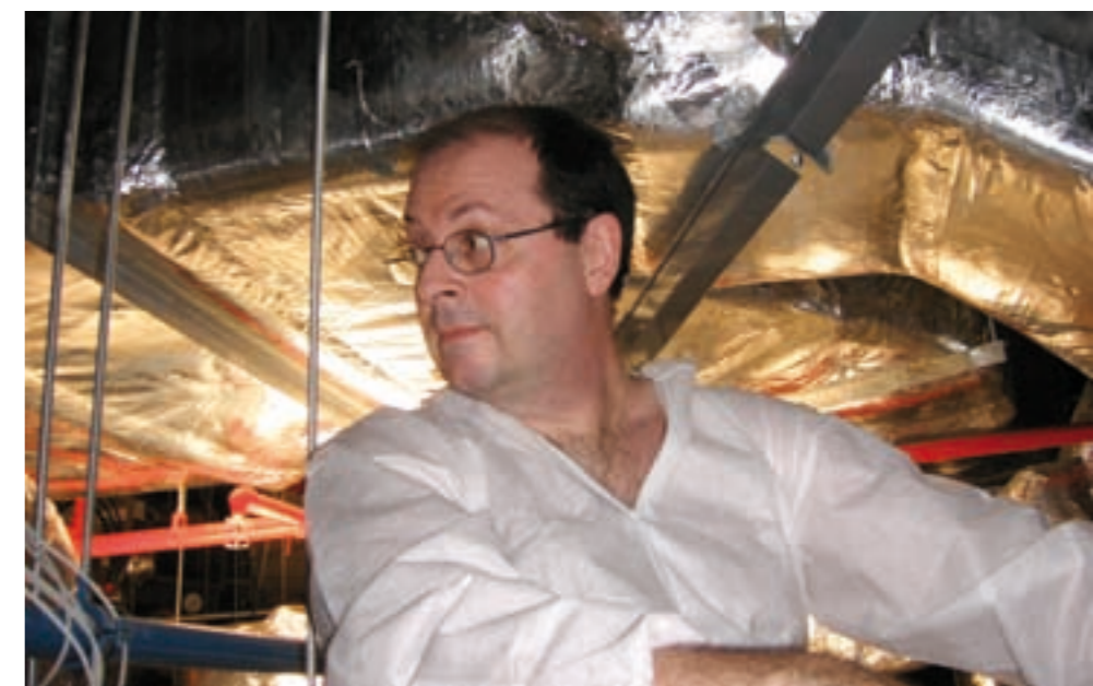
Dr. Charles Taillens prüft die BSL3 Klimaanlage
